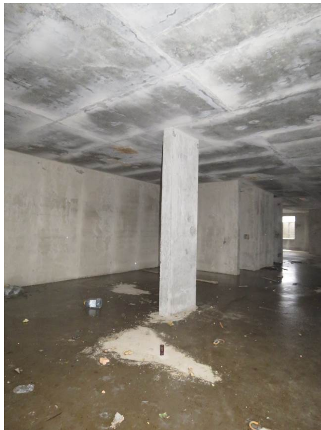
Рис. 3.1.8. Замачивание верхней поверхности фундаментной плиты с последующим замерзанием и фазового перехода воды в лед на высоту до 50 мм
